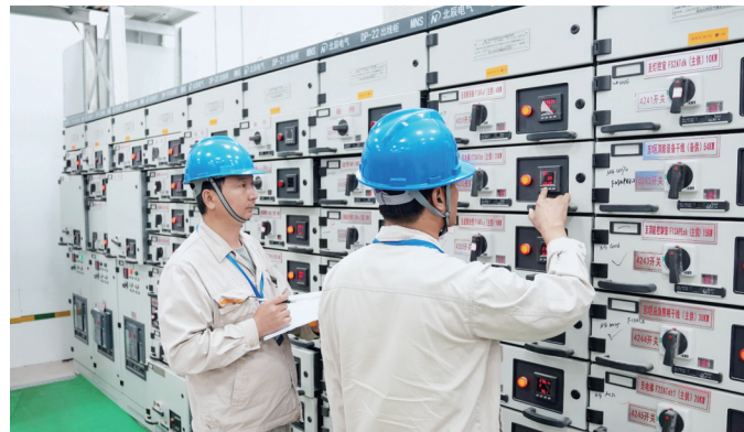
工作人员对设备电压、电流、温度等进行检测。
