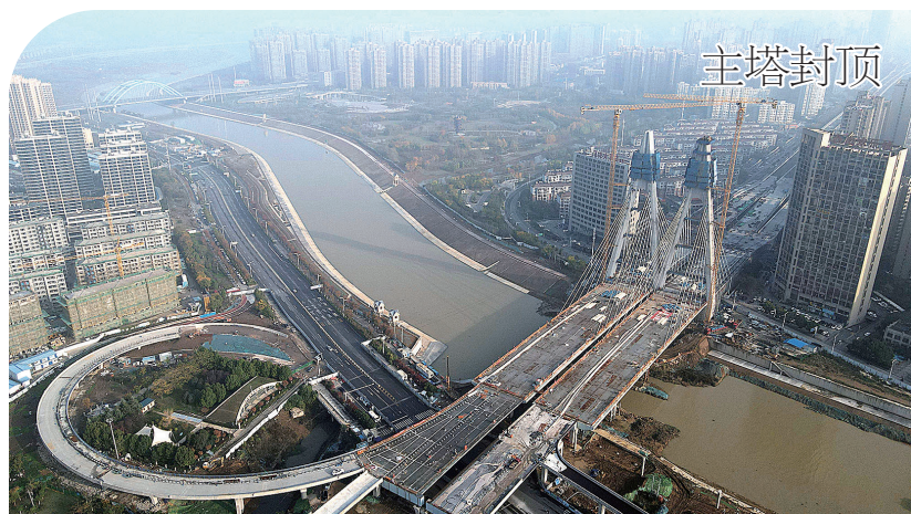
这是正在进行主塔封顶施工的引江济淮金寨南路桥(11月24日摄,无人机照片)。当日,由中铁四局承建的引江济淮工程江淮沟通段金寨南路桥主塔封顶。引江济淮工程沟通长江、淮河两大水系,是我国跨流域、跨省重大战略性水资源配置和综合利用工程。新华社记者 刘军喜 摄
