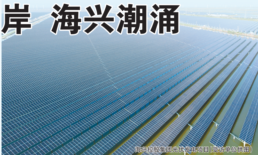
海兴控股集团光伏发电项目(受访单位供图)
