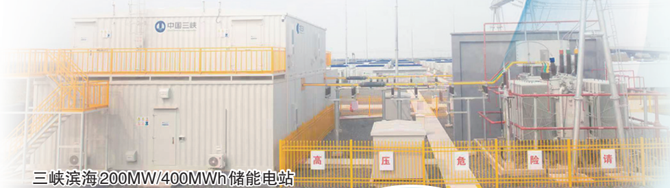
三峡滨海200MW/400MWh储能电站
