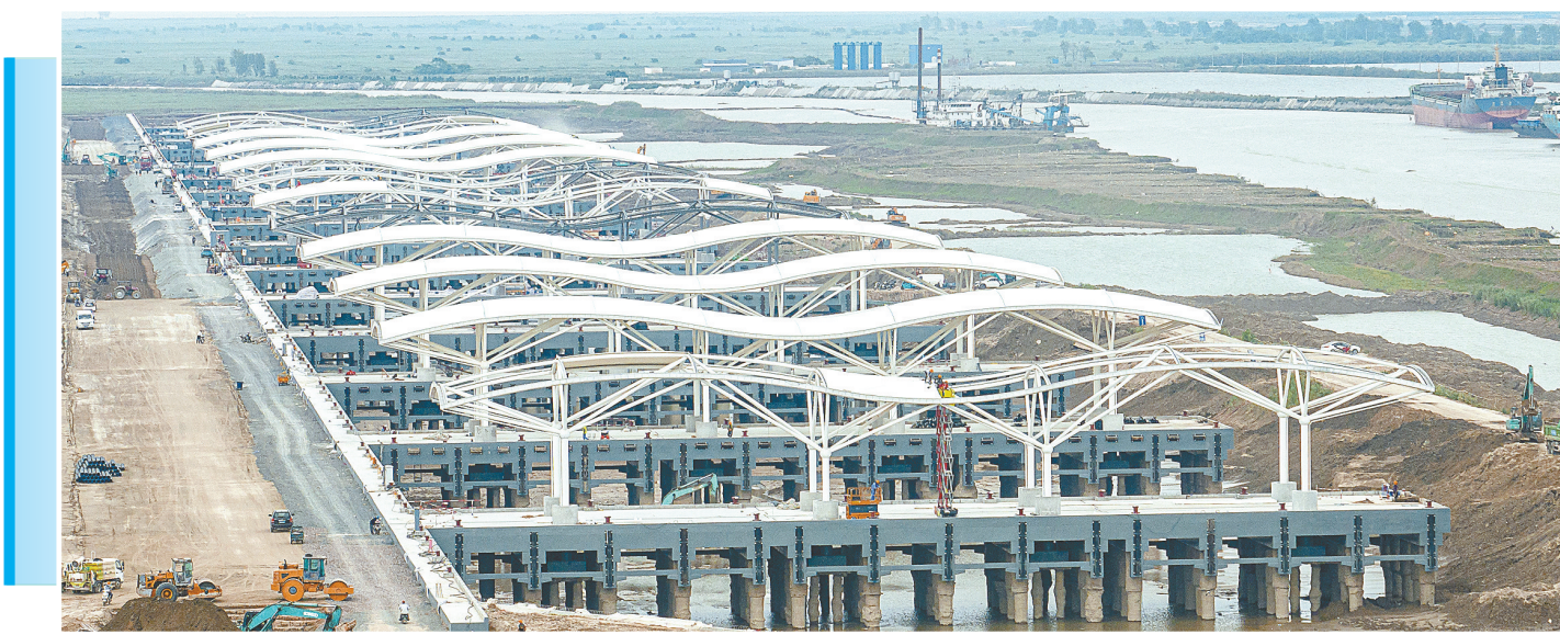
作为省重大项目之一，黄沙港国家级中心渔港二期改造工程总投资61.34亿元，计划新增码头岸线2228米，新增避风水域60万平方米，将建成国内首个同时实现加油加冰的码头，力争打造成为国内第一个智慧渔港、全国第二大渔港。图为忙碌的项目建设现场。 记者 杨毅 通讯员 彭岭 摄
