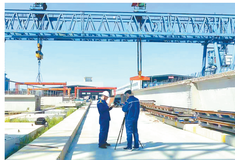
近日,省特检院盐城分院机电室安排两名检验人员,来到华设盐城智能制造有限公司进行检验,为特种设备安全运行保驾护航。检验员对该公司两台通用门式起重机移装实施监督检验,并要求施工单位按照规范做好隐患整改和闭环管理。王勇 严扬 摄
