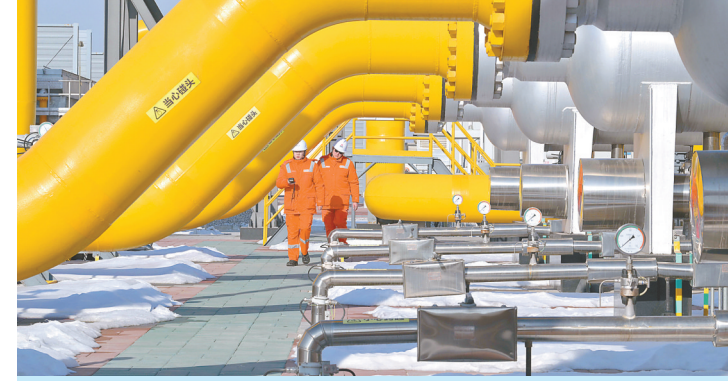
近日,工人在国家管网唐山联络压气站内工作。去年入冬以来,位于河北省唐山市丰润区的国家管网唐山联络压气站的工作人员,不断加大天然气管网和机器设备的巡检力度,排查隐患,确保供气安全。据介绍,国家管网唐山联络压气站是中俄东线中段天然气管道联络压气站,其任务是将来自俄罗斯的天然气过滤、增压后输送至永清压气站,保证京津冀地区天然气供应。新华社记者 杨世尧 摄
