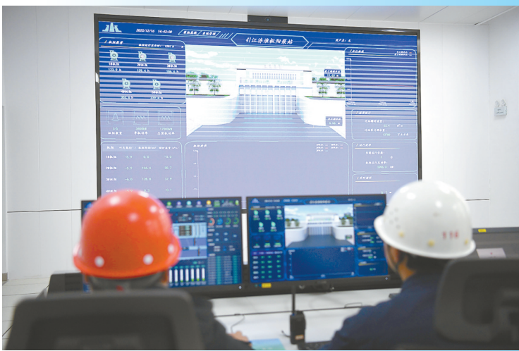
12月16日,工作人员在引江济淮枞阳泵站中央控制室工作。
