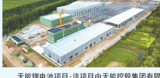
天能锂电池项目:该项目由天能控股集团有限公司投资建设,当期计划投资10.7亿元,年处理废旧锂电池及含镍、钴、锂原材料9.5万吨,年产硫酸钴3.5万吨、氯化钴1万吨、硫酸镍3.6万吨、硫酸锰1.2万吨、碳酸锂6000吨。
