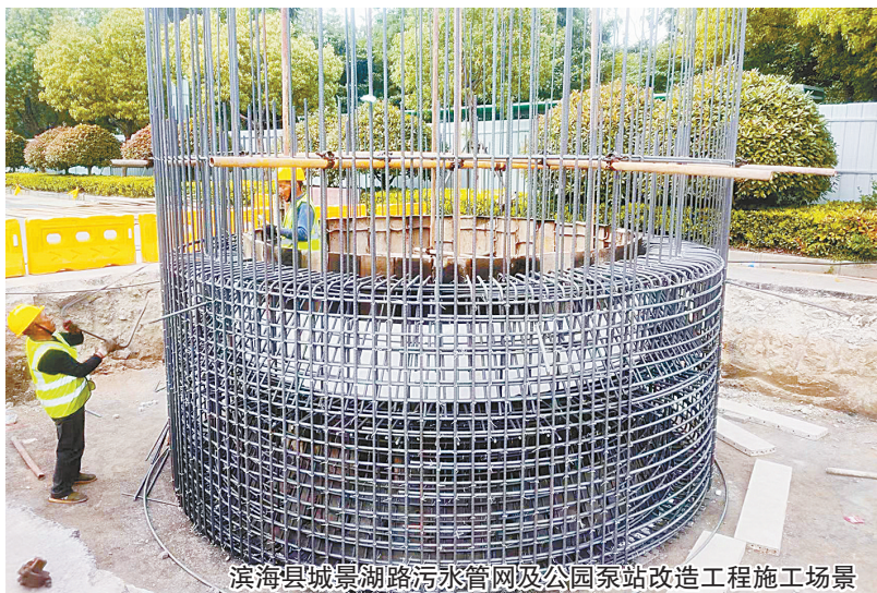
滨海县城景湖路污水管网及公园泵站改造工程施工现场
