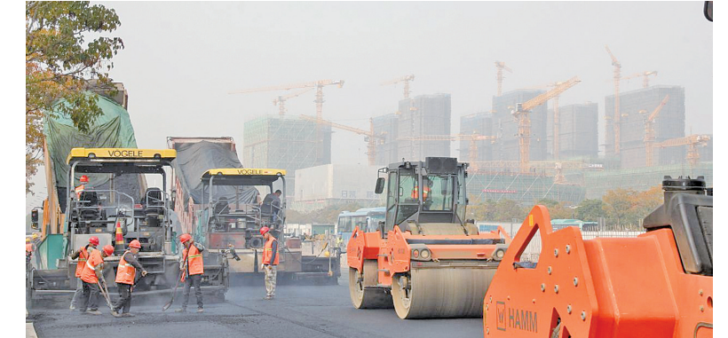
11月1日上午8时许,高架四期青年路西延工程施工现场,12台重型沥青运输车来回穿梭,经过约5小时的连续作业,青年路西延工程首段沥青下面层摊铺工作顺利完成。高架四期项目对拉开城市框架、完善城市功能、提升城市发展能级具有重要意义。 孙宏连 熊昊 摄
