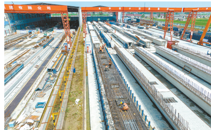
在343国道盐丰快速通道YF3标预制梁场，工人顶着烈日进行预制箱梁施工。 通讯员 顾枫 记者 施豪 摄
