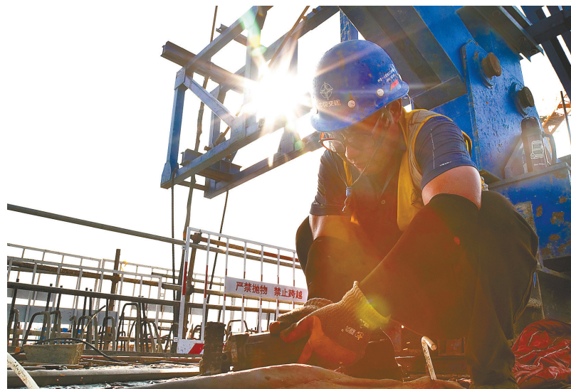
连日来，高温天气让全市各地建设工地面临“烤”验。图为阜溧高速建湖至兴化段工程工作人员头顶烈日全力奋战。
