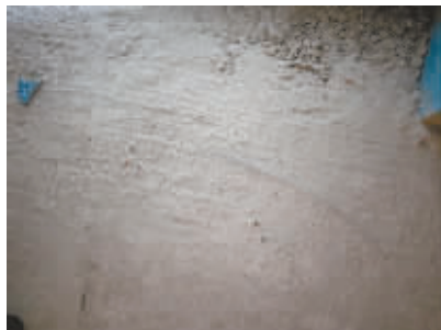
地暖找平地面出现露管、起砂。
