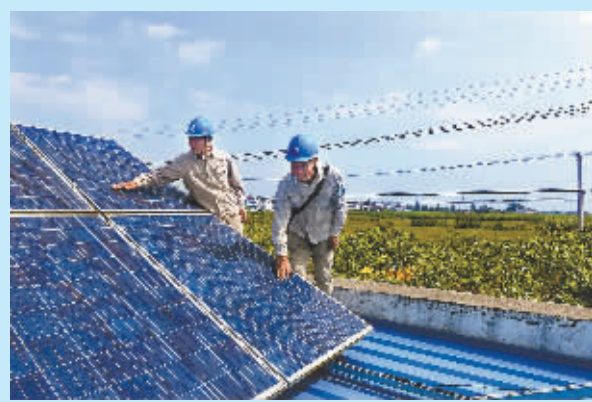
东台供电公司富安供电所员工到蚕农周书云家检查光伏发电电池板及线路情况。
