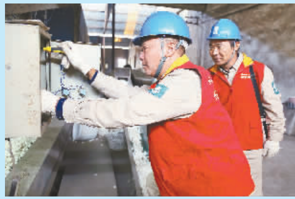
东台供电公司共产党员服务队在富南茧站检查蚕茧烘干机控制箱。
