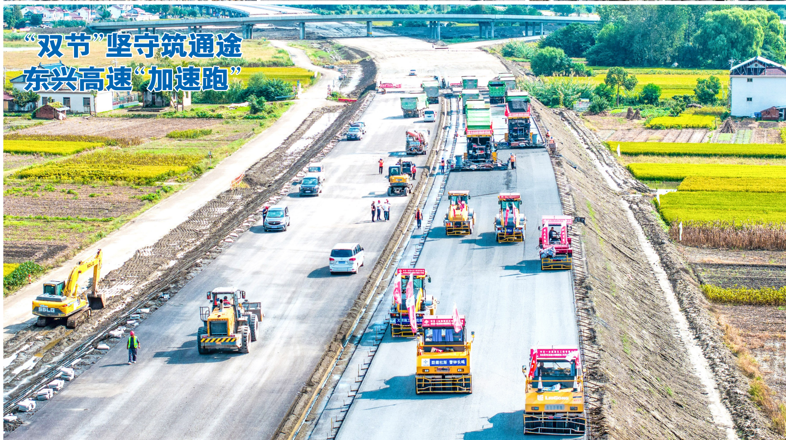
10月4日,东兴高速东台段的建筑工地热火朝天,数百名建设者坚守施工一线,全力推动项目建设。市交建中心加大现场安全巡查和隐患排查力度,值班人员活跃在各个作业点,反复叮嘱注意事项,对已完工的水稳层厚度、压实度以及桩基施工质量进行实时跟踪,确保指标符合设计规范。 顾枫 记者 周晨阳 摄
