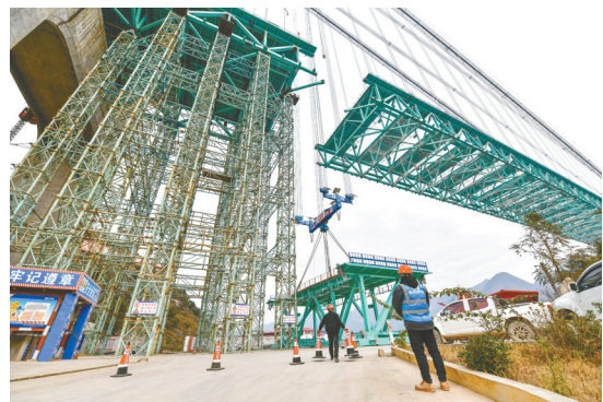
↑2025年1月14日,工人在为吊装贵州花江峡谷大桥最后一个节段钢桁梁做准备。 新华社记者 杨文斌 摄
