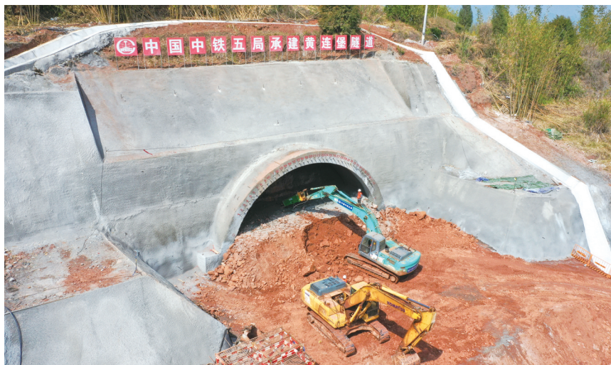
梁镇的成渝中线高铁首座隧道——黄莲堡隧道施工现场(无人机照片)。当日,由中铁二院设计、中铁五局承建的成渝地区双城经济圈建设重点工程成渝中线高铁首座隧道——黄莲堡隧道顺利进洞开始施工,这标志着成渝中线高铁全线建设进入快车道。 新华社记者 唐奕 摄
