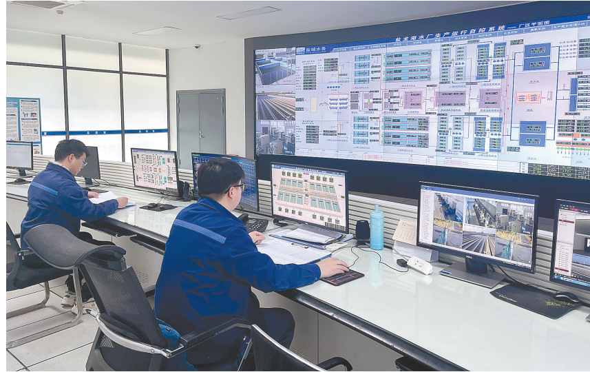
2月24日，城投水务集团盐龙湖水厂中控室内，调度人员紧盯生产运行自控屏幕，细致分析每一组参数，全力守护水厂安全平稳运行。
