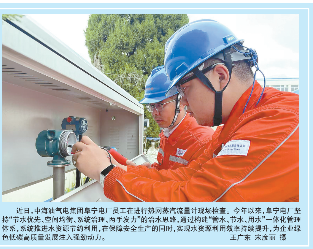
近日,中海油气电集团阜宁电厂员工在进行热网蒸汽流量计现场检查。今年以来,阜宁电厂坚持“节水优先、空间均衡、系统治理、两手发力”的治水思路,通过构建“管水、节水、用水”一体化管理体系,系统推进水资源节约利用,在保障安全生产的同时,实现水资源利用效率持续提升,为企业绿色低碳高质量发展注入强劲动力。 王广东 宋彦丽 摄
