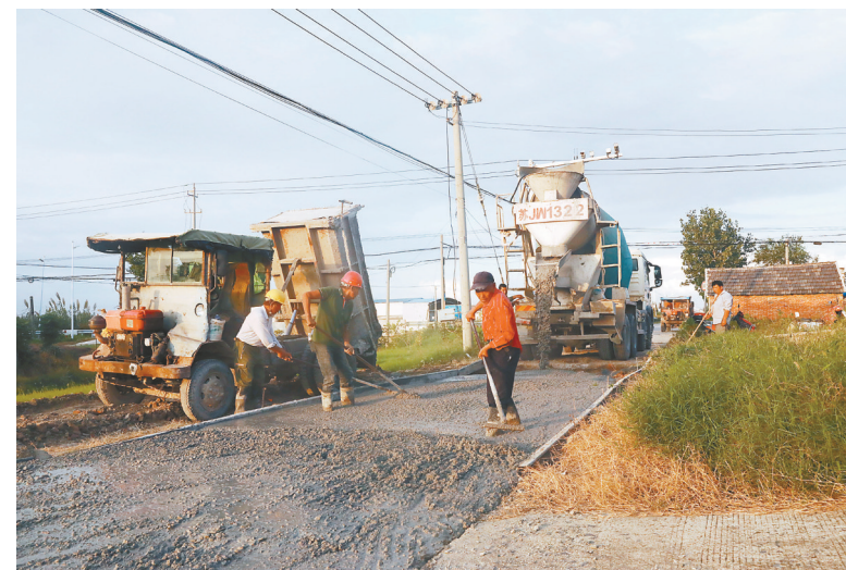
9月23日,大丰区白驹镇新垛村四组北横河南岸,农村公路养护工人正忙着修补水泥路面。该镇提前深入调查统计辖区道路破损情况,科学制定整修计划,精心组织施工,全力确保秋收大忙到来前完成道路修补保养工作,保障各类农业机械、车辆安全顺畅通行,为秋收生产保驾护航。 董汝涛 张忠贵 摄
