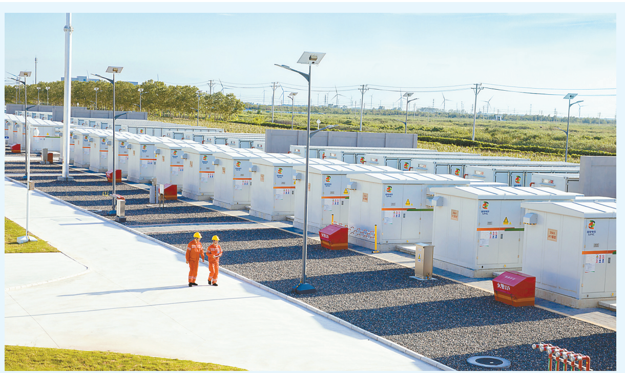
建于滨海经济开发区内的国家电投滨海独立新型储能项目,会根据电网通道利用情况和用电负荷情况灵活进行调峰服务,推动当地迎峰度夏期间电力稳定供应、安全运行。图为工作人员对储能设施进行巡检。刘伟 记者 张一轩 摄
