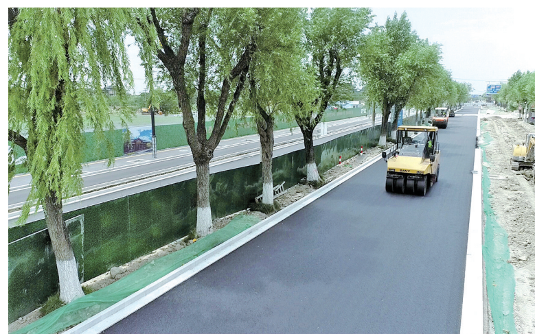
近日,在东台市宁树路改造工程施工现场,大型运输车与沥青摊铺机、压路机等默契配合作业,一派繁忙景象。目前,该工程已进入最后冲刺阶段,预计7月底全面竣工。
