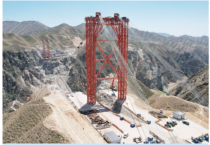
这是5月10日拍摄的兰永临高速公路洮河大桥索塔吊装系统(无人机照片)。当日,由中铁二十局承建的兰(兰州)永(永靖)临(临夏)高速公路关键控制性工程洮河大桥500吨大型索塔吊装系统试吊成功,标志着这一横跨洮河的上承式钢管混凝土拱桥正式进入主体结构施工阶段。洮河大桥是兰永临高速公路的“咽喉”工程,大桥全长562.16米,主桥采用净跨400米上承式钢管混凝土拱桥设计。兰永临高速公路全长131.86公里,建成通车后将有效分流乌玛高速公路兰州段的车辆,对完善甘肃高速公路网和促进沿线区域经济社会发展具有重要意义。新华社记者 陈斌 摄
