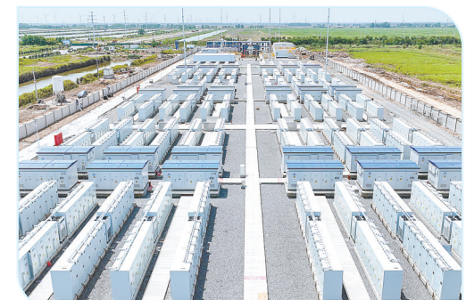
三峡滨海储能电站项目
