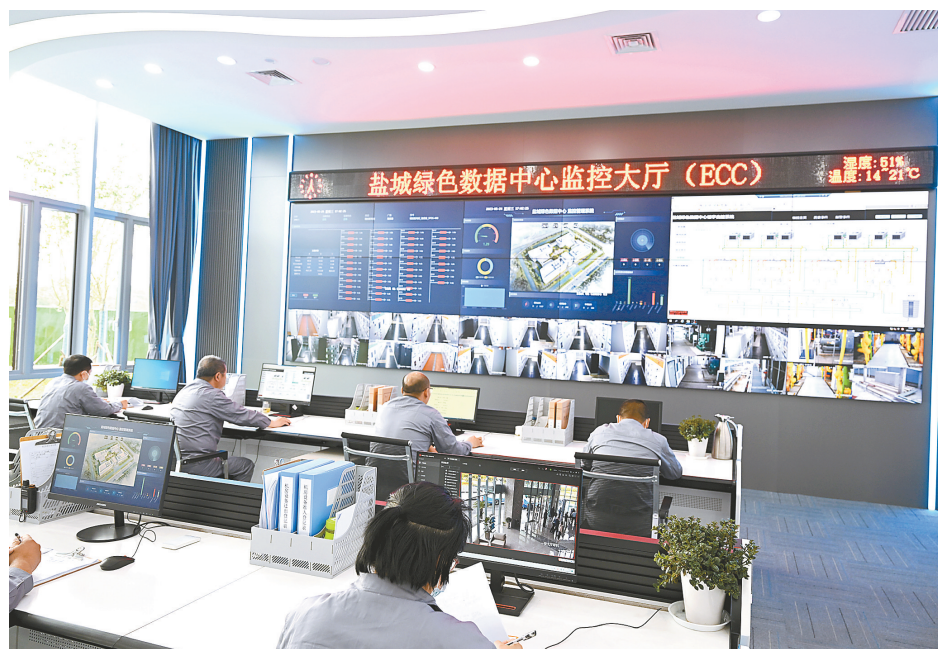
盐城绿色数据中心监控大厅(资料图)
