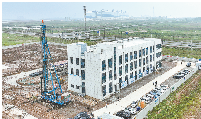
滨海港片区冷能交换中心一期项目位于滨海经一路东侧、六合路西侧，总投资约2.5亿元，预计今年10月正式投入运营。该项目建成后，将向冻干果蔬、冰雪世界、冷链物流、算力中心等下游用户长期稳定供应技术成熟、价格优惠的冷源。
