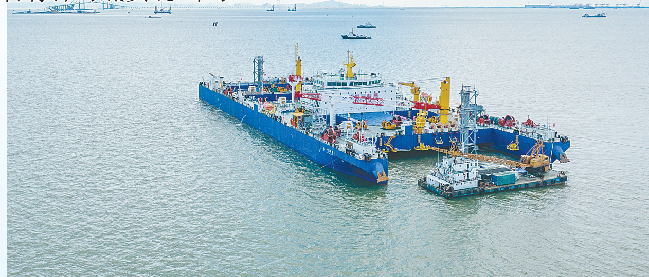
“航津安1”号沉管运输安装一体船在沉放安装E23管节和最终接头,背后是建设中的深中通道伶仃洋大桥(6月9日摄,无人机照片)。
